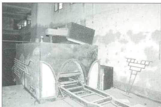
Poškozený interiér krematoria.
